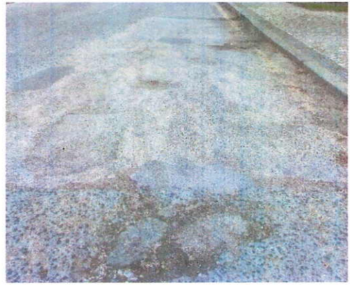
VIAS DE MÁ CONSTRUÇÃO
